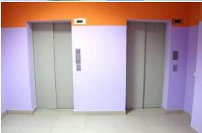
Учебный корпус оборудован лифтами
